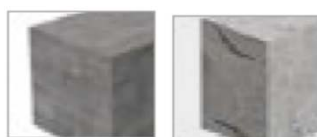
Betão fissurado e
